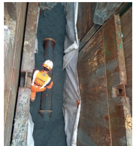
Opérateur au fond d'une tranchée, protégé par un blindage, en train de poser une conduite d'assainissement.
